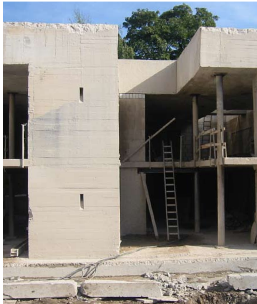
Die Betonarbeiten beim Umbau des Hochbunkers dauerten dreieinhalb Monate. Dabei reduzierte sich das Gewicht des Gebäudes um 5000 Tonnen.
